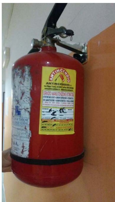
Foto 18 – Estintore con revisione scaduta
