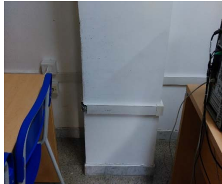
Foto 15 – Canalina per fili
