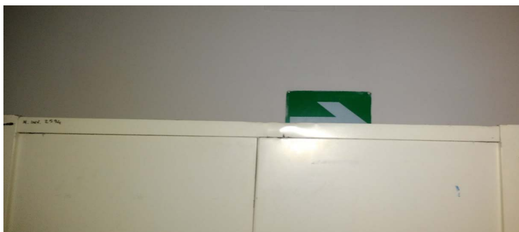
Foto 6 – Segnaletica via di esodo
